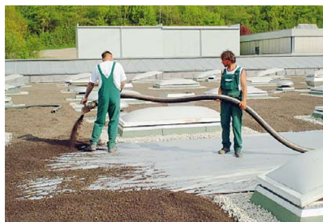
▲ Das Aufbringen der Substratschicht erfolgt in der Regel mit speziellen Silofahrzeugen und wird daher von Gründachbetrieben erledigt
